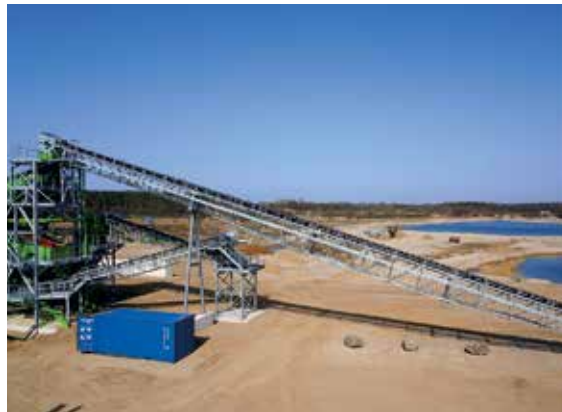
In Zurow hat die Heidelberger Sand und Kies GmbH ein modernes neues Kieswerk errichtet, das auch zukünftig die Versorgung der Stammkunden aus der Betonindustrie mit hochwertigen Gesteinskörnungen sicherstellen soll, Foto: BGR.
