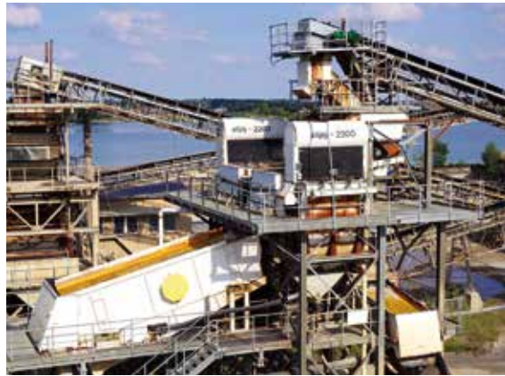
Im KW Sprotta der Niemeier Baustoffgruppe ist die Produktion von kohlefreien Gesteinskörnungen von höchster Priorität. Zur Entkohlung der Kiese kommen hierfür Setzmaschinen des Typs alljig® der Firma allmineral Aufbereitungstechnik zum Einsatz, Foto: BGR.
