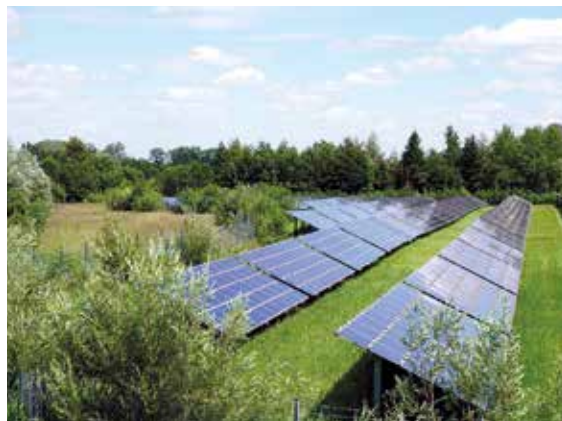
60 % des benötigten Energiebedarfs des KW Schemmerhofen wird durch die Kieswerke Dünkel GmbH & Co. KG mit grünem Strom aus einem eigenen stationären Solarpark gedeckt, Foto: BGR.
