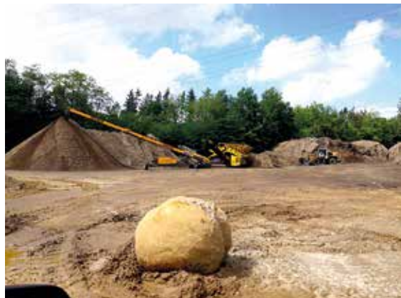
Im KW Hittfeld südlich Hamburg steht neben der Kiessandgewinnung das maximale Recycling von Böden und Bauschutt im Fokus aller Tätigkeiten, Foto: BGR.
