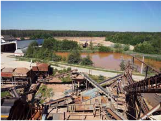
Blick vom KW Pressath-Dießfurt auf das östlich des Werkes liegende derzeitige Auskiesungsgelände im Staatsforst „Mark“, Foto: BGR.
