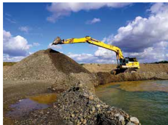
Im KW Vienenburg der Raulf-Oppermann GmbH wird der steinige Rohkies der Oker- aue mittels Tieflöffelbagger gewonnen, Foto: BGR.
