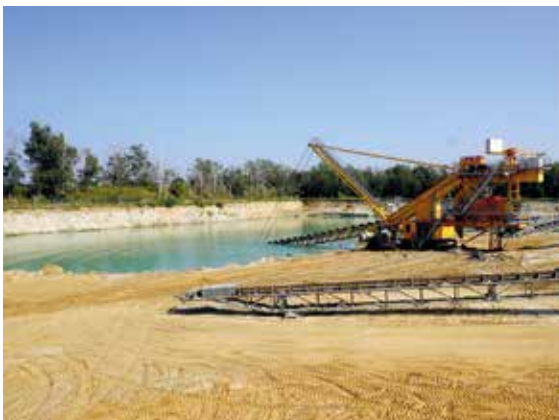
Im KW Otterwisch der Betonwerk Bad Lausick GmbH & Co. KG ist seit wenigen Jahren ein neuer, landgestützter Eimerkettenbagger in Betrieb, Foto: BGR.
